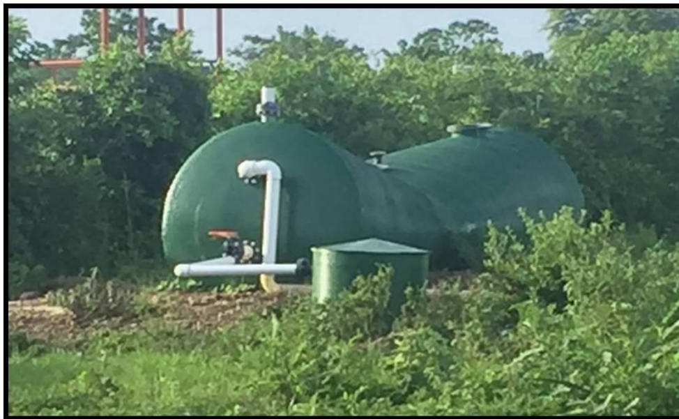
Biodigestor instalado en el complejo ferial.
